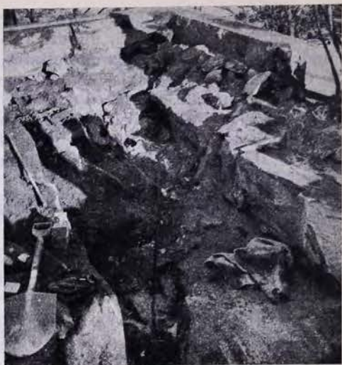
Bild 3. Norra landfästet avläckt.
